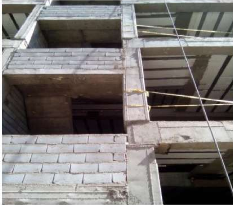
قالب بندی نامناسب در محل اتصال تیر به ستون و اجرای نامناسب تغییر مقطع ستون بتنی
