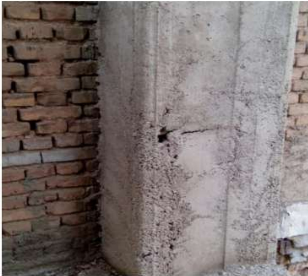
عدم تراکم کافی بتن و دانه بندی نامناسب
