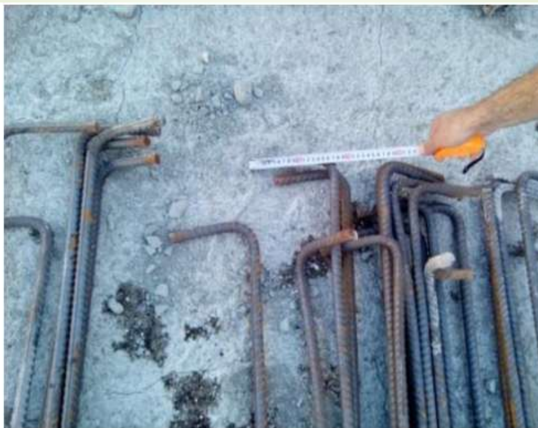
طول خم انتهای آرماتور کمتر از 12db (دوازده برابر قطر آرماتور) کمتر است.
